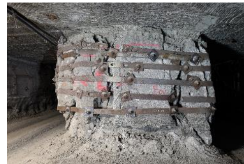
Fissuration des piliers centraux en galerie double
