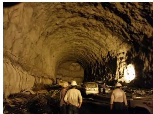
Vue de la caverne hydroélectrique de Tehri (Inde)
