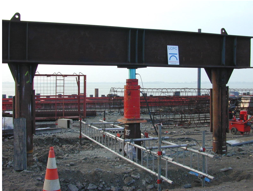
Figure 6. Dispositif en cours d'essai
