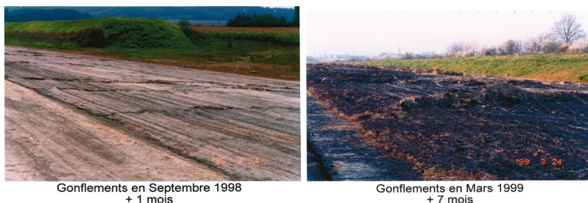
Figure 1 : manifestation des désordres (Source : Laboratoire Central de Morangis, Vinci Construction)
