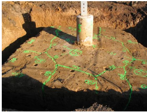
Figure 7 : Report des fissures affectant la dalle traitée
